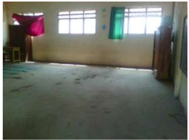
Kondisi Lantai Ruang Kelas I
