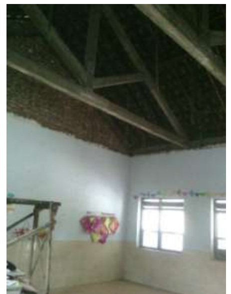
Kondisi Atap Ruang keas II
